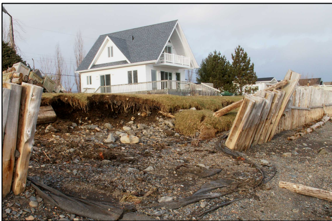
Figure 7. Muret brisé par les vagues de tempêtes du 2 décembre 2005, secteur de la pointe Verte.
