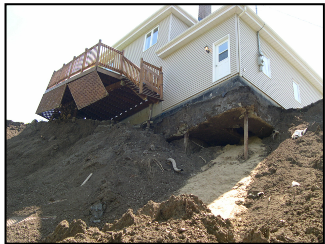
Figure 2 – Glissement rotationnel dans des sols argileux, ayant affecté les fondations d'une résidence (rivière Delisle, 2005)
