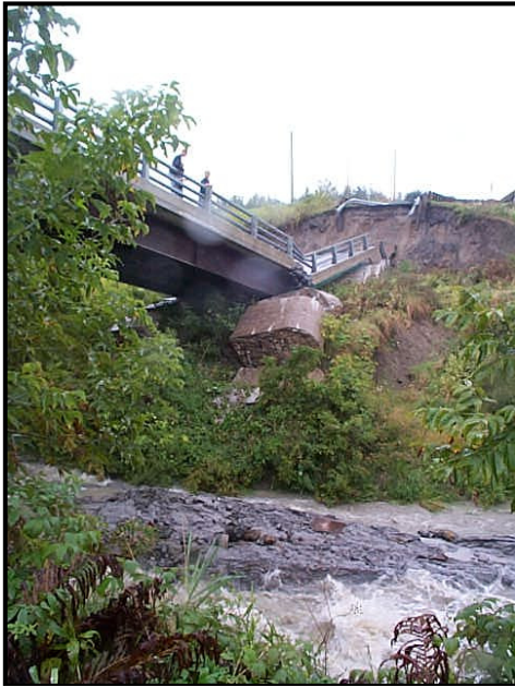
Figure 3 –Glissement rotationnel profond ayant endommagé les structures d'un pont (rivière Salvail, 2000)
