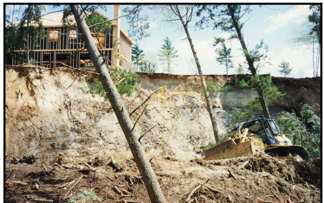
Figure 5 –Glissement de terrain récent déclenché par la mise en place en sommet de talus d'un remblai non contrôlé, à proximité d'une maison en construction. On voit au premier plan les matériaux de remblai sur lesquels repose le boteur qui a été entraîné avec le mouvement des débris lors de la rupture
