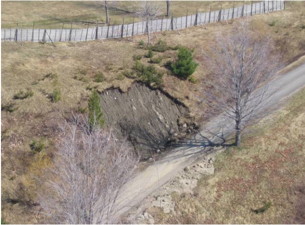
Figure 5. Exemple d'un glissement superficiel dans un talus d'excavation.
