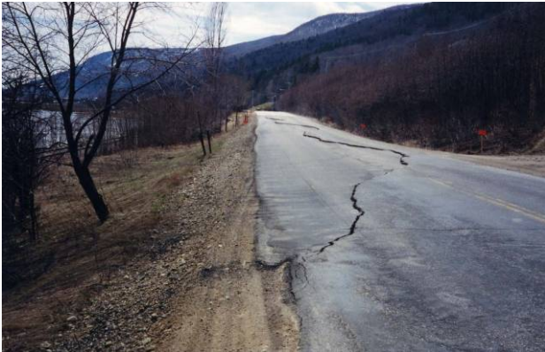
Figure 9. Photographie de la fissure qui apparaissait épisodiquement au milieu de la route avant la stabilisation
